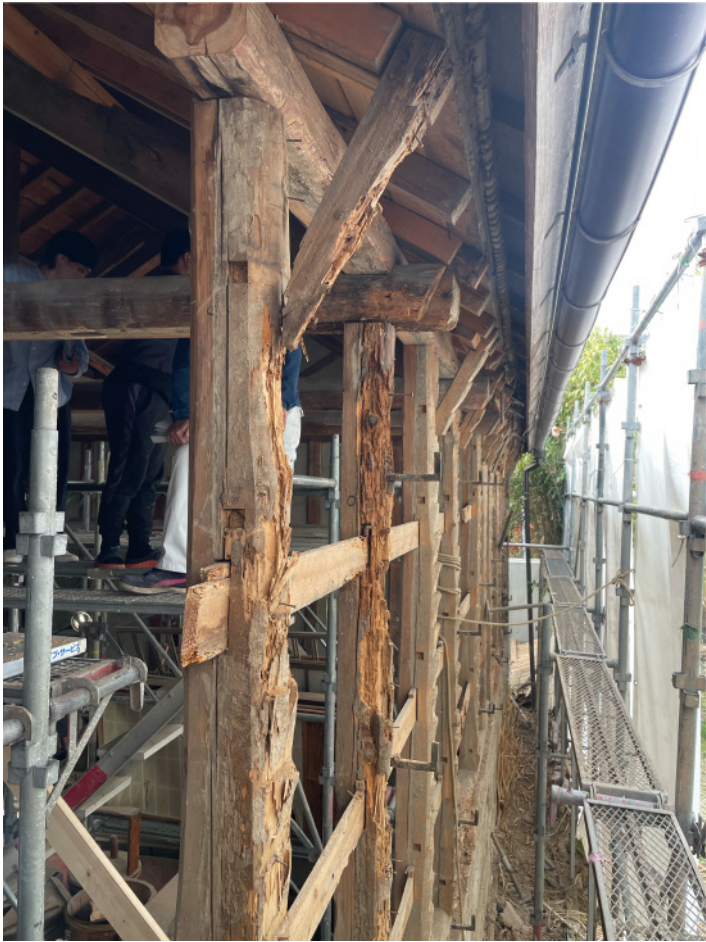
北側外壁の腐朽
