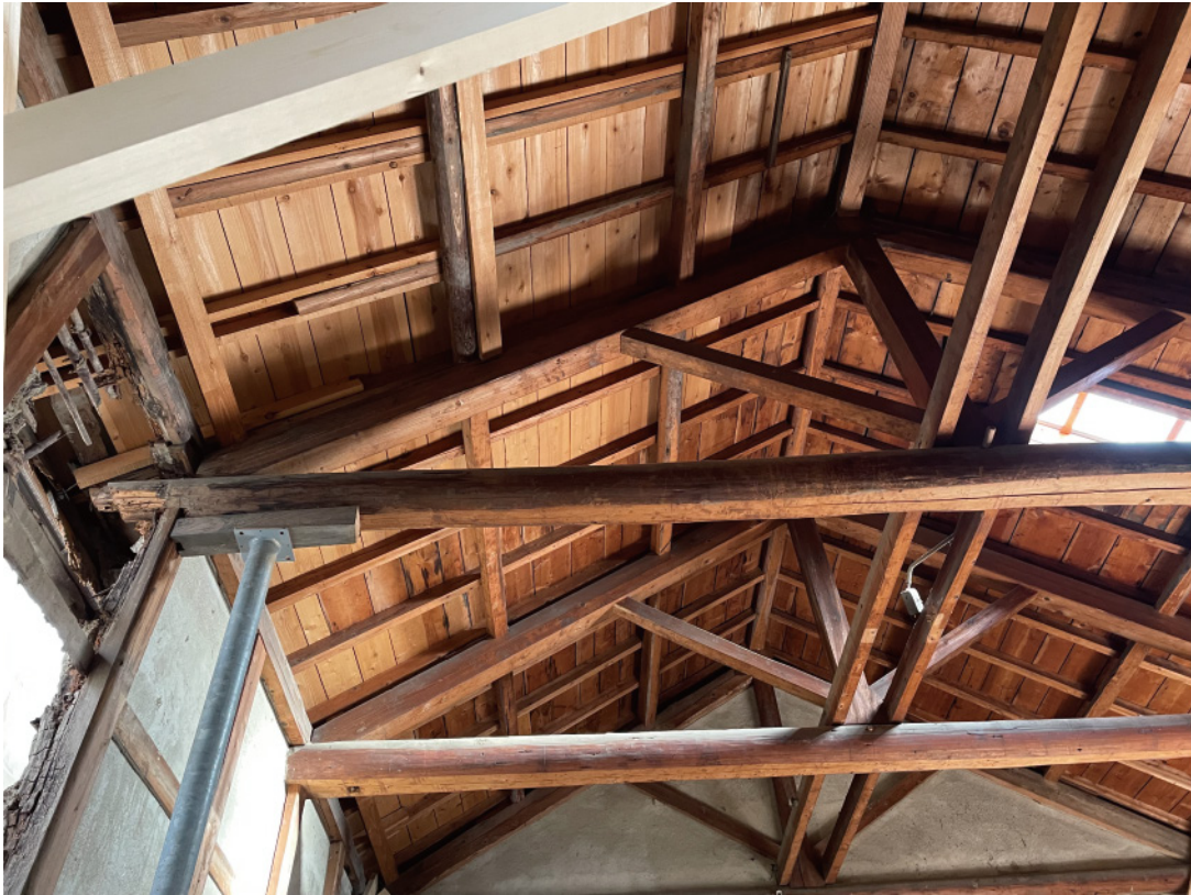
梁端部の腐朽
